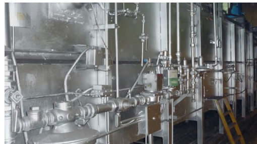
回火炉和天然气阀门管道系统
